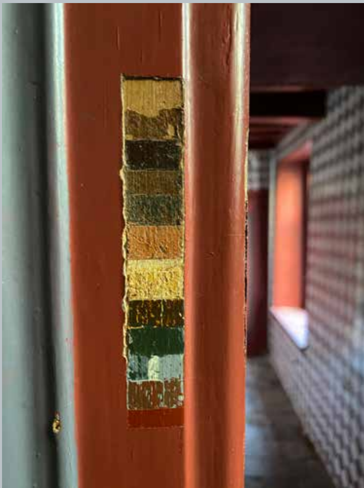
Kleuretrapje van een kozijn in de keuken met 11 zichtbare kleurlagen. Bij nader onderzoek onder de microscoop blijkt het schilderwerk opgebouwd uit maar liefst 26 kleurlagen waarvan de oudsten al in de 18de eeuw zijn aangebracht (foto team Erfgoed Zwolle).
