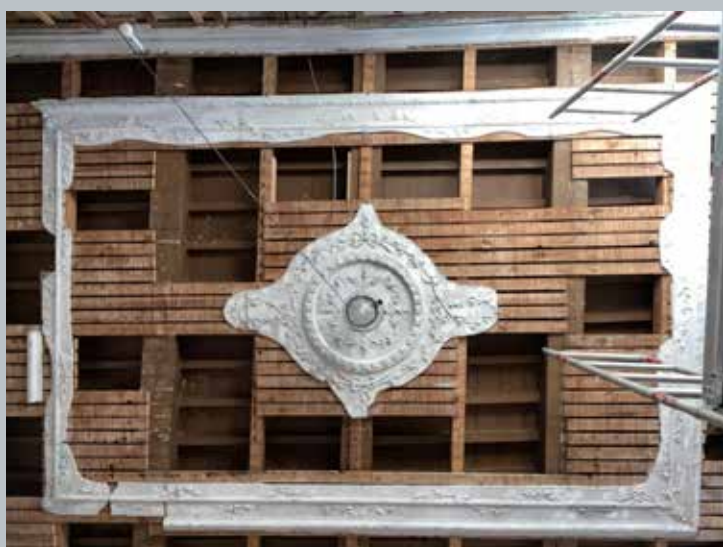
Onder het door brand zwaar beschadigde plafond in de linker achterkamer is het oorspronkelijke plafond met moer en kinderbinten met de historische kleur te zien. Het stuc op rietplafond is op de smalle plankjes gemonteerd (foto: team Erfgoed Zwolle).
